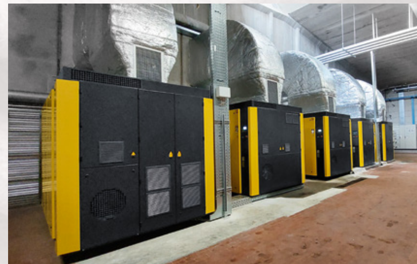
Photo de gauche : Cervotessile est réputé pour ses produits haut de gamme. Photo de droite : La nouvelle station d'air comprimé constituée de cinq compresseurs à vis KAESER.
