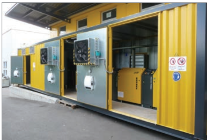
Soufflantes pour l'aération des eaux usées
