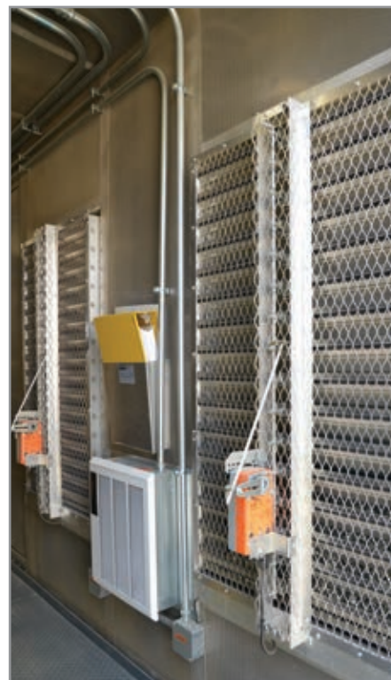
Volets d'aération à commande thermostatique et chauffage de l'enceinte
