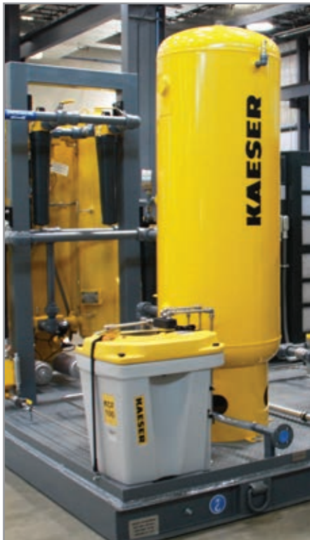
Réservoirs d'air comprimé et gestion des condensats
