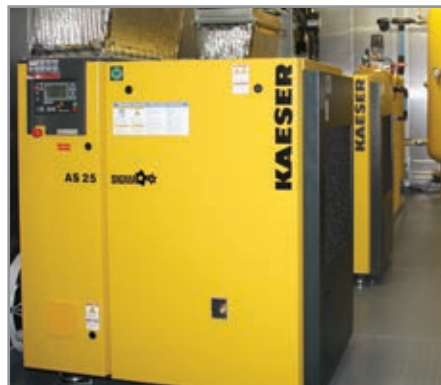
Compresseurs à vis
